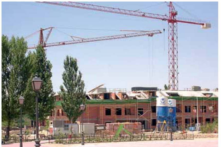
Viviendas en construcción este mes de julio en la proximidad del parque 'El Juncal'
