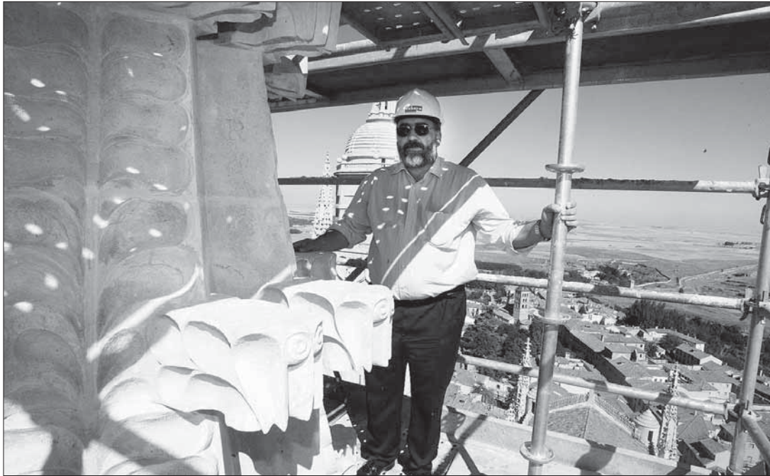
Luciano Mucio observó el desarrollo de las obras en el cimborrio, tanto en el exterior como en el interior de la Catedral FERNANDO PEÑALOSA
