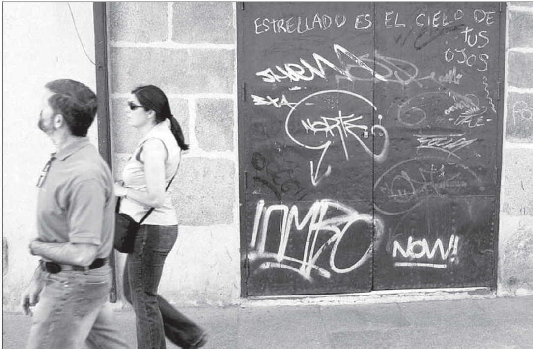
La mayoría de las personas detenidas lo fueron por efectuar "graffitis" en fachadas de edificios
