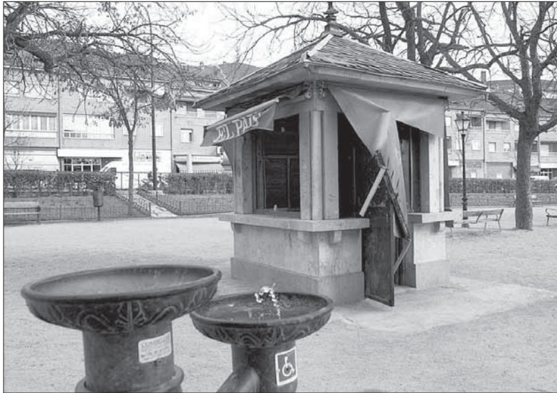
Kiosco situado en el barrio de San Lorenzo que, previsiblemente, será derribado
