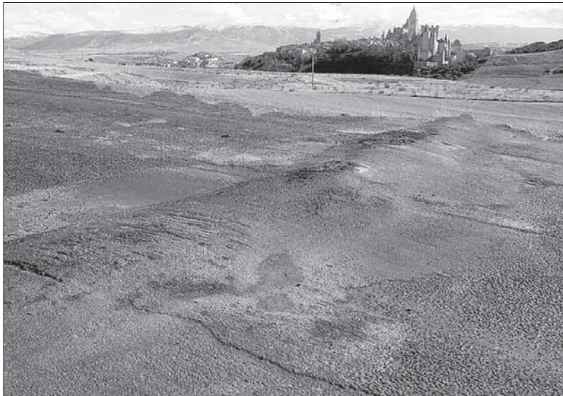
Vecinos y transportistas se han quejado del bache de la carretera del vertedero
