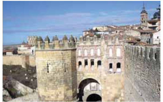
Puerta de San Andrés, sede de un centro de interpretación de la muralla segoviana
