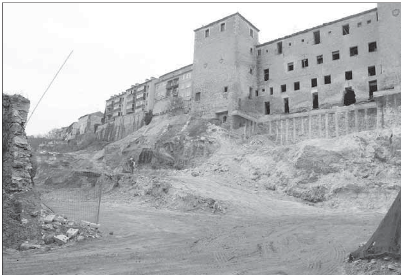
Imagen de las obras de excavación en el solar del antiguo convento de Las Oblatas
