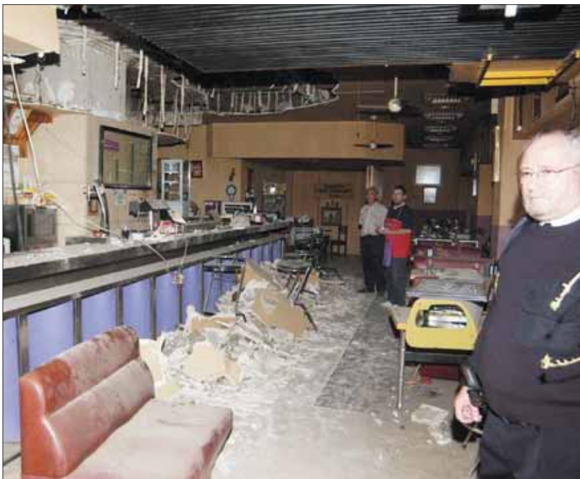
Estado en el que quedó el bar de la estación de autobuses, después del desprendimiento
