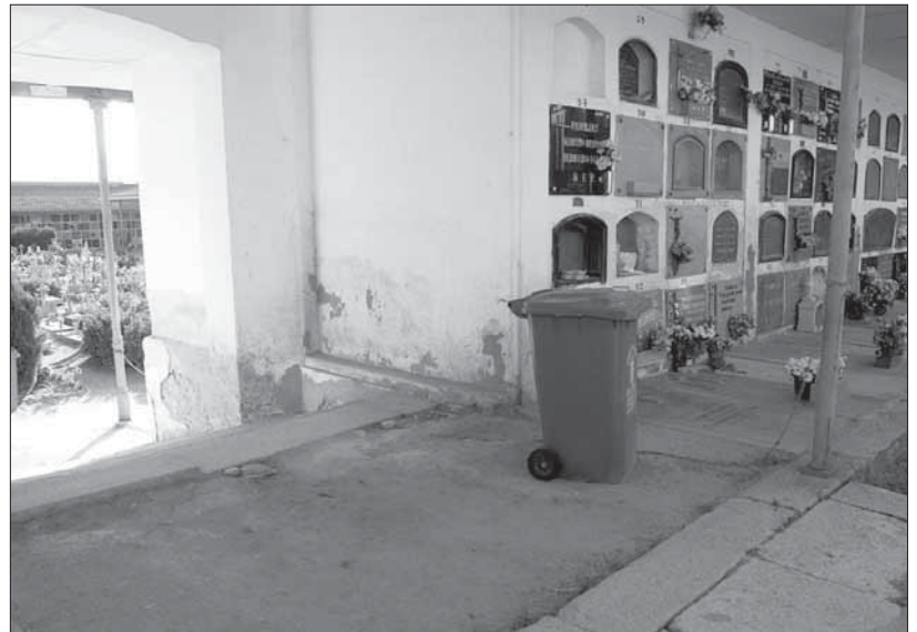
El desnivel entre los patios 1 y 2, causa de las inundaciones durante los días de lluvia
