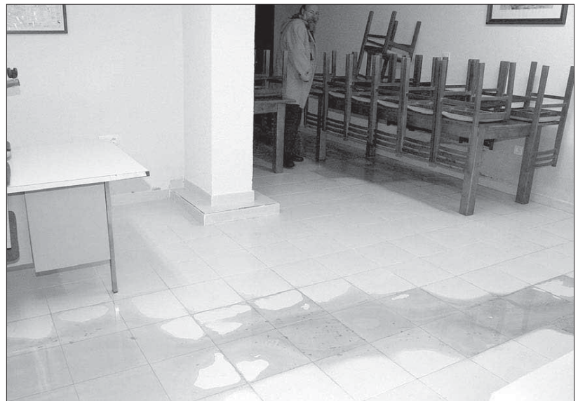
La sede de la Federación de Vecinos sufrió filtraciones de aguas sucias hace alrededor de un año. JUAN MARTÍN
