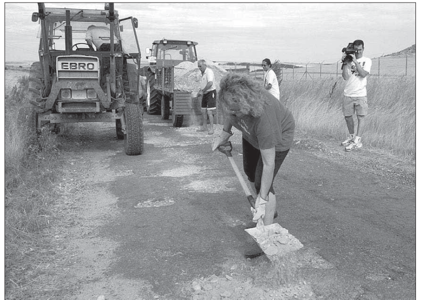
Imagen de los vecinos arreglando los accesos al barrio, el pasado domingo
