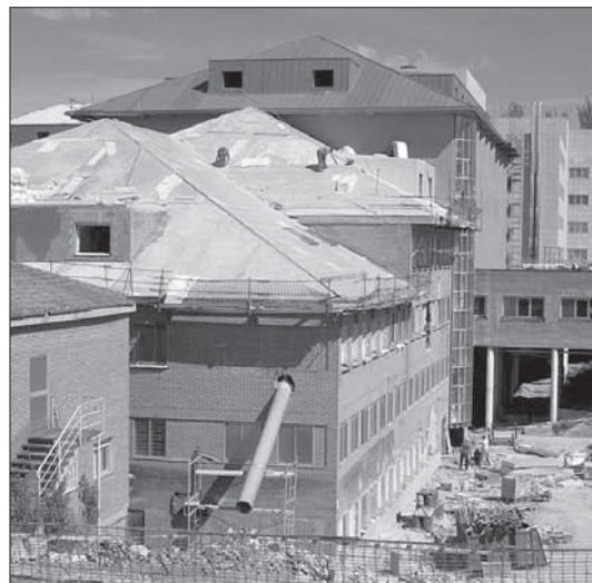
Obras en la cubierta por donde se ha filtrado lluvia JUAN MARTIN
