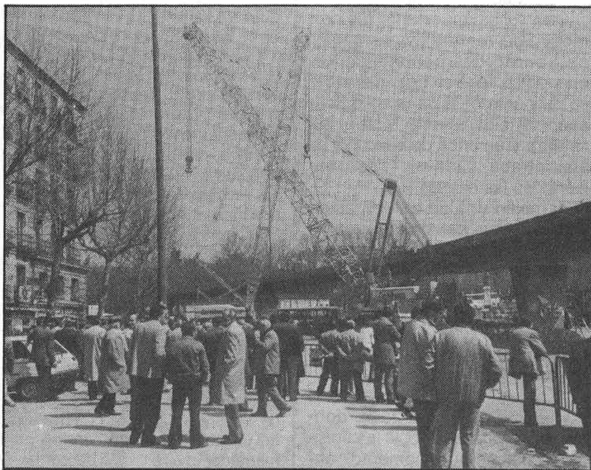
Una de las gigantescas grúas sufrió una avería el pasado domingo, por lo que se demoró el inicio del desmontaje varias horas, con la consiguiente desesperación del «respetable».
