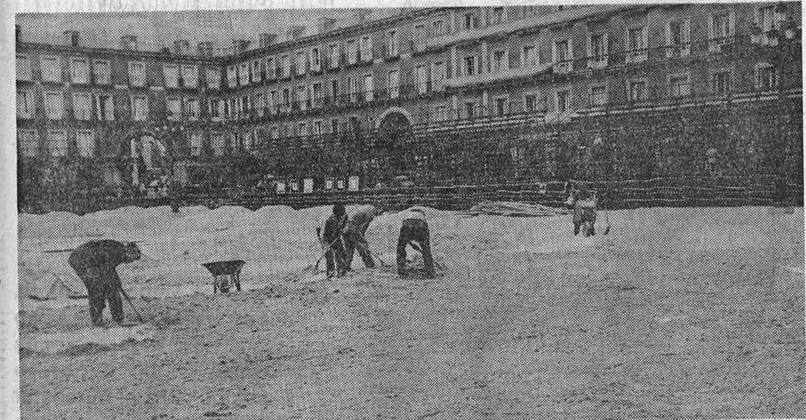
Un verdadero mar de arena se está derramando estos días sobre el piso empedrado de la plaza Mayor de Madrid, al tiempo que se alcanzan los típicos soportales unas enormes estructuras metálicas. Todo este monumental tinglado despierta la curiosidad de los madrileños, que acuden en gran número a contemplar la marcha de las obras. Pero la cosa no tiene nada de extraño, y la explicación de todo ello es que en este precioso marco de la plaza Mayor van a celebrarse las anunciadas fiestas medievales que organiza el Círculo de Bellas Artes y patrocinia el Ayuntamiento de Madrid. Aquí veremos, pues, torneos, justas poéticas, juegos de cañas y lanzas, bohemia, estafetas y hasta alancear toros al estilo medieval, a cargo de los hermanos Peralta. El acontecimiento está llamando poderosamente la atención en España y fuera de ella. (Foto Fiel.)
