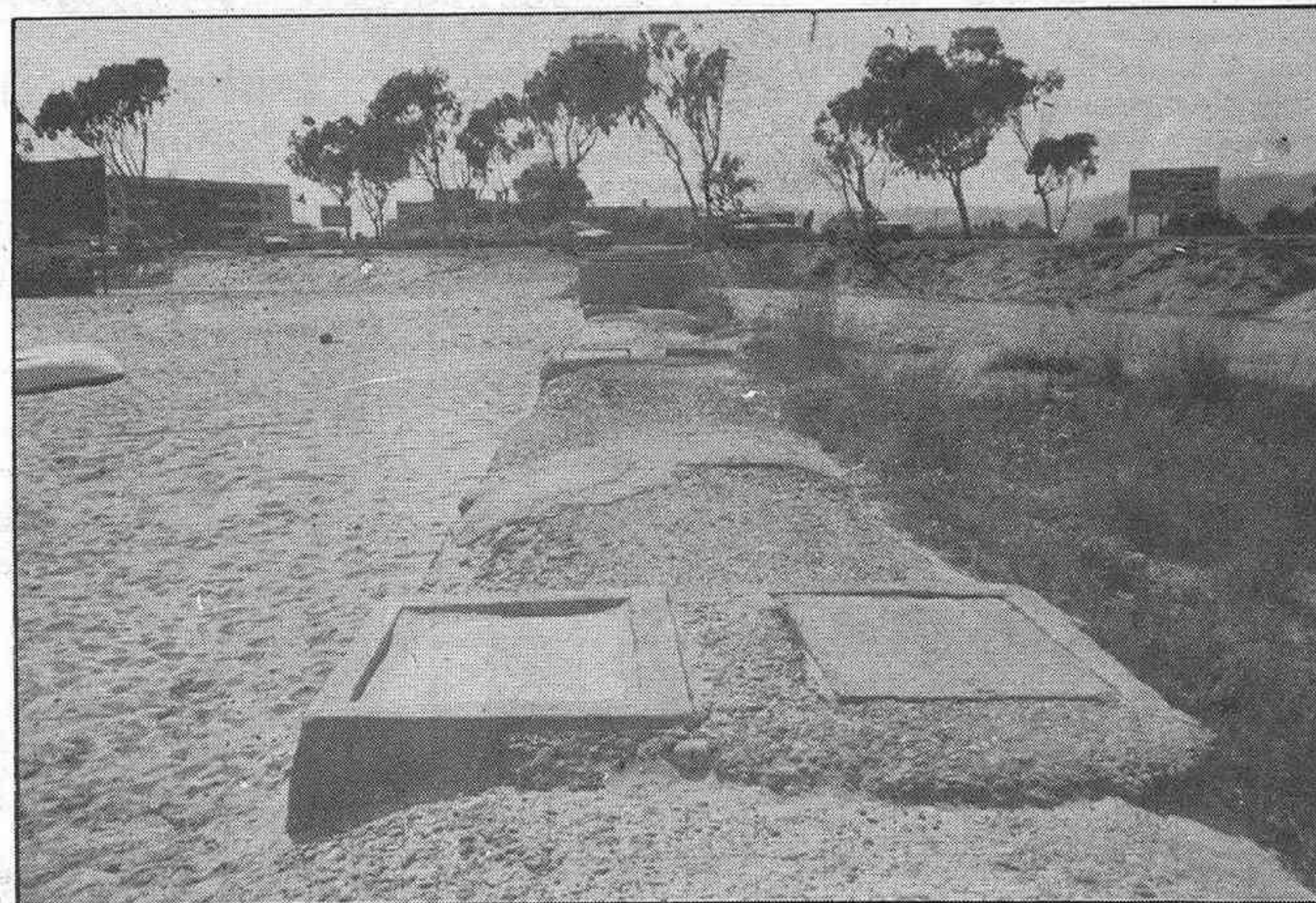
Por este conducto ya no se vierten aguas residuales a la playa
