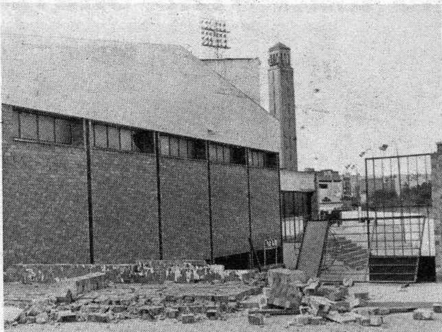
Un muro lateral junto al polideportivo de Castalia, derribado por la fuerza del viento.
