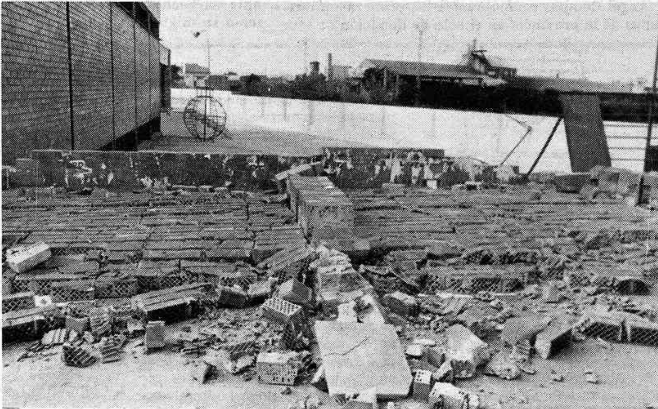
Una pared del Estadio Castalia se vino abajo por la fuerza del viento (Foto Heredio)
