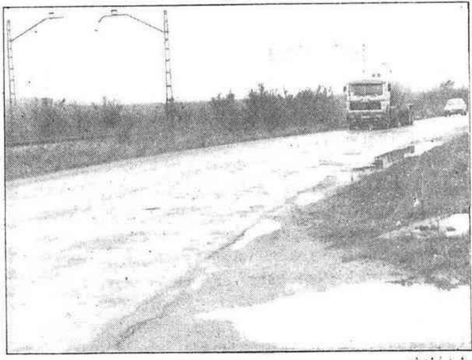
Este es el tramo, de irregular pavimento, que se inunda cuando llueve. Los coches, al intentar salvarlo, pueden acabar en la vecina vía del tren.
