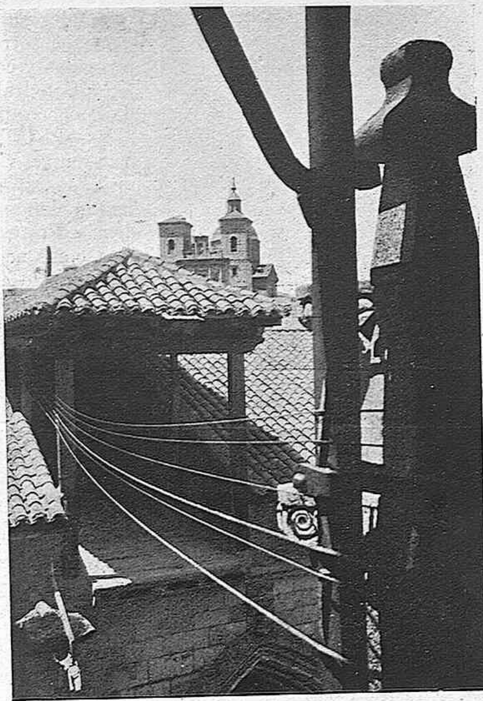
UNA DEFECTUOSA Y PELIGROSA INSTALACIÓN ELÉCTRICA
