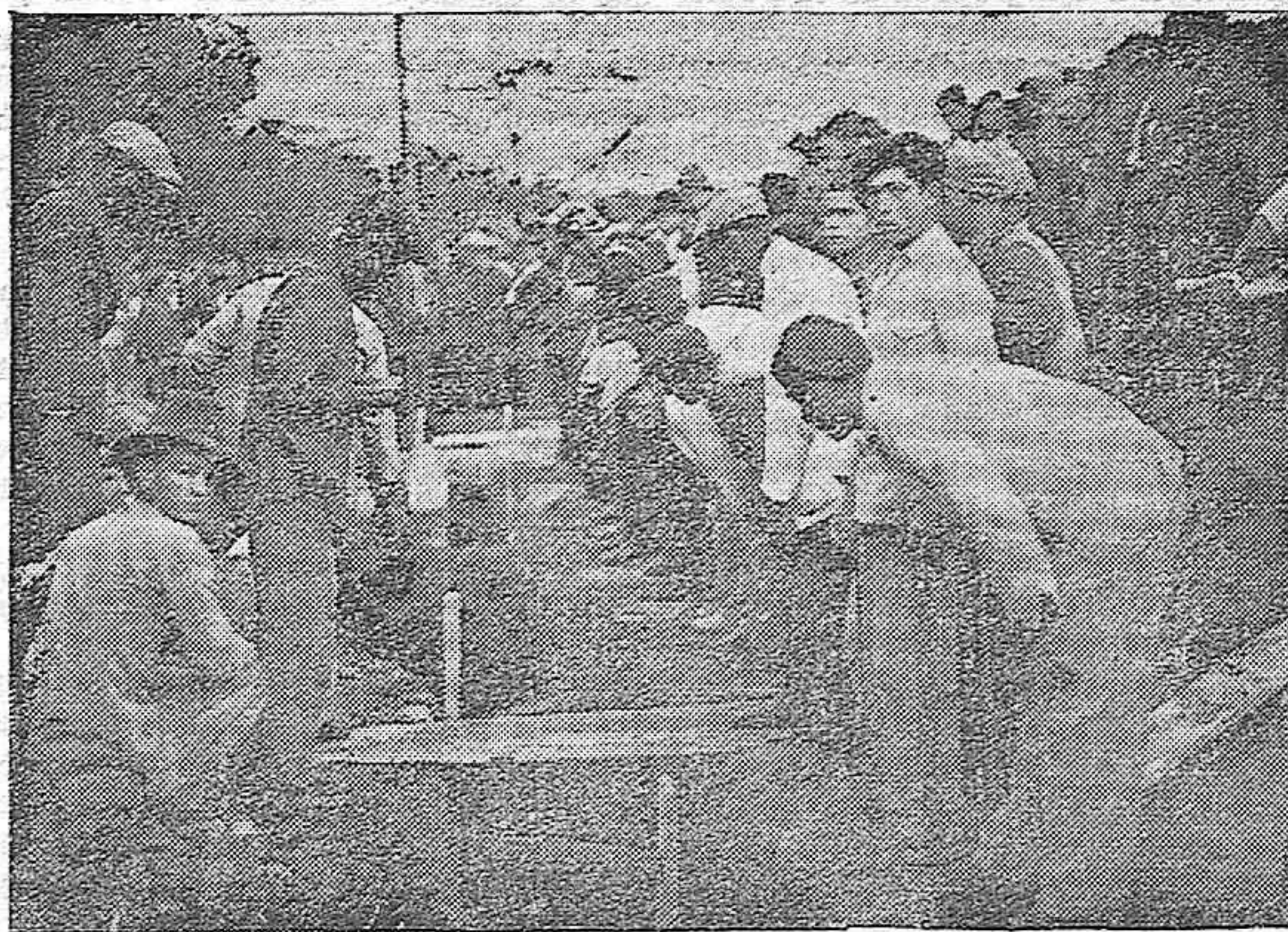
EL DESGRACIADO SUCESO DE AYER.—Los bomberos y obreros albañiles, trabajando con afán en el hundimiento habido en la obra próxima al Stadium para extraer al compañero que quedó sepultado y perdió la vida
