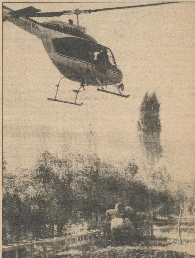
La coordinación entre tierra y aire tiene que ser perfecta. La pérdida de tiempo es la peor aliada en este impresionante proyecto.
