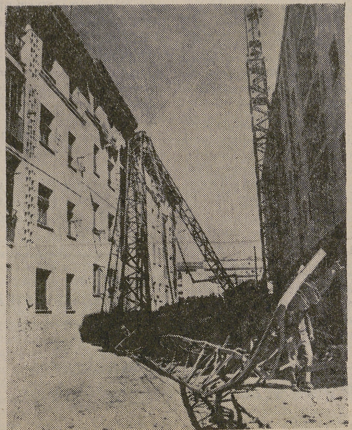
La grúa desplomada sobre el edificio.—(Foto: MAYORAL).
