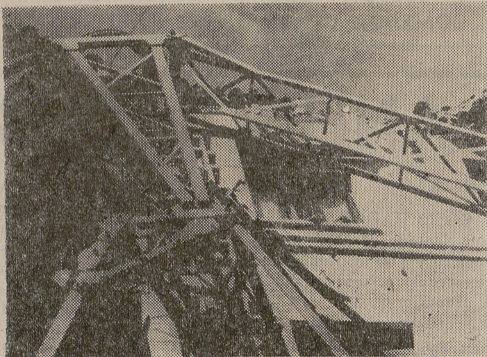
Detalle de los desperfectos ocasionados.—(Foto: JOSE LUIS).
