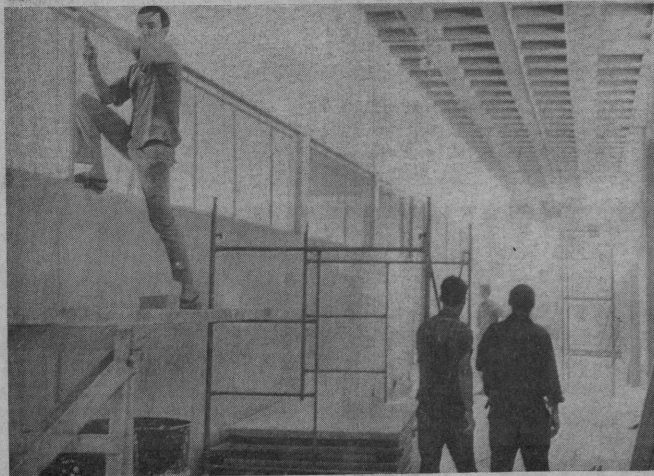
Madrid.—Los obreros se afanan en la puesta a punto del pabellón del INI, de la Casa de Campo, que entrará este curso en servicio para los alumnos de Derecho y Económicas de la nueva Universidad Autónoma de Madrid. Este pabellón dará cabida a los estudiantes de primer curso de ambas ramas en tanto se construyen los nuevos edificios de la Universidad Autónoma.—(Foto Europa Pres)
