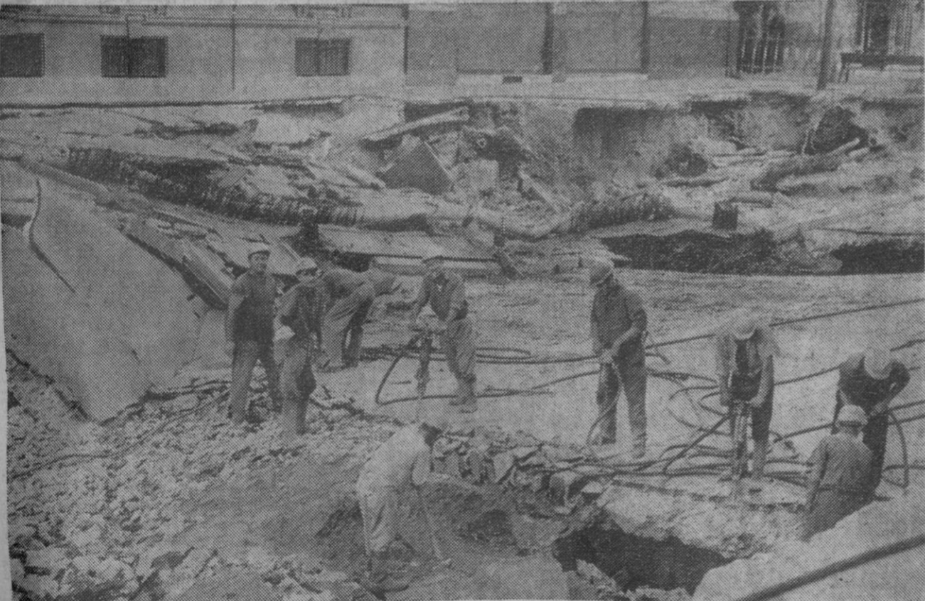
Madrid.—Brigadas de obreros trabajan activamente para devolver lo antes posible a su estado normal el enorme tramo de la calle Almagro que se desplomó inesperadamente, arrastrando consigo doce vehículos. (Foto Europa Press)
