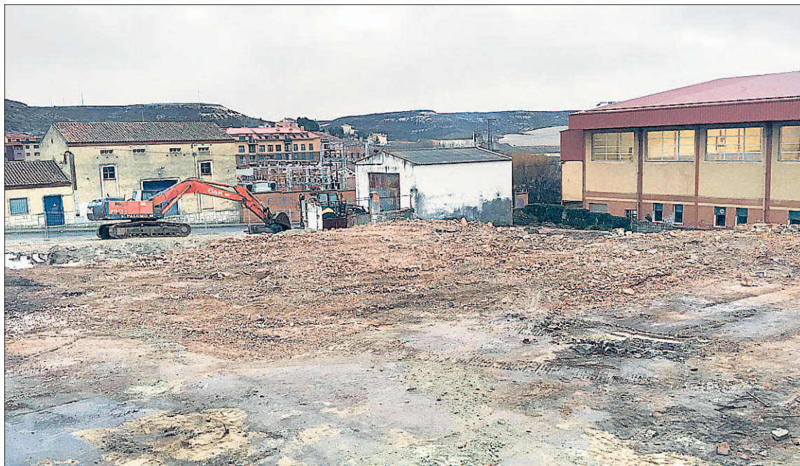
Parcela del antiguo matadero, donde se ubicará el nuevo centro de salud, en los días de su demolición en 2017. / C. N.
