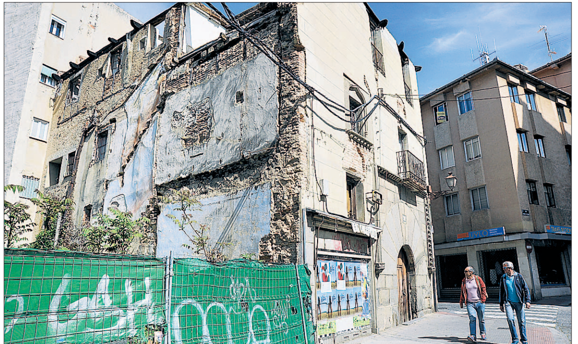
El edificio conocido como Casa de los Buitrago se encuentra en estado de ruina desde hace años. / KAMARERO
