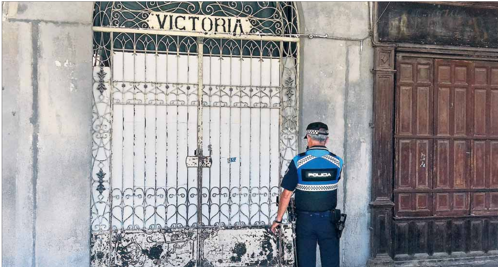
El antiguo hotel Victoria está situado en la Plaza Mayor de Segovia. Su estado es prácticamente ruinoso en el interior, aunque la fachada está consolidada y no supone peligro alguno para los vecinos. / E. A.
