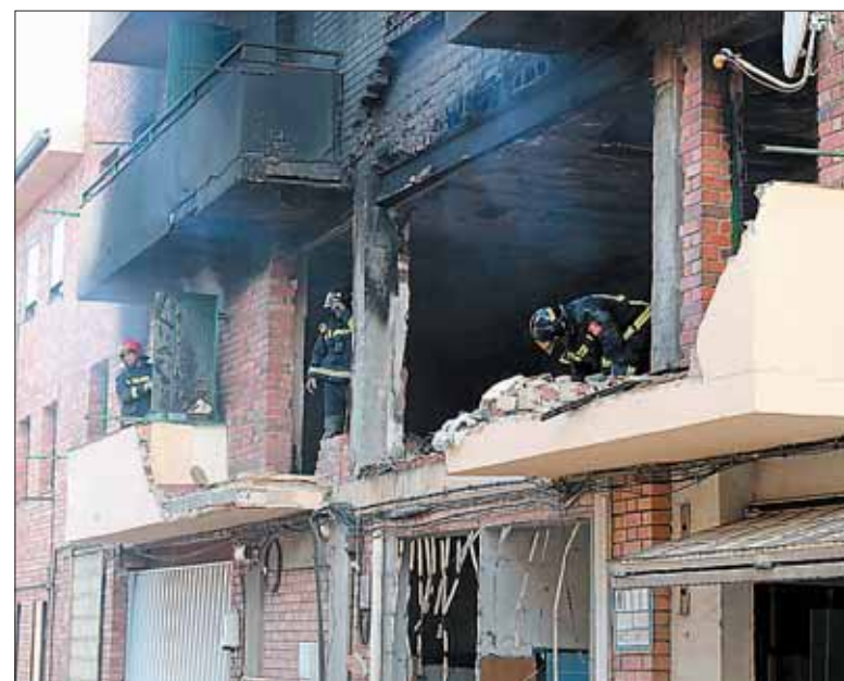
Estado en el que quedó el edificio de la calle Coca tras la explosión de agosto. /M.G.
