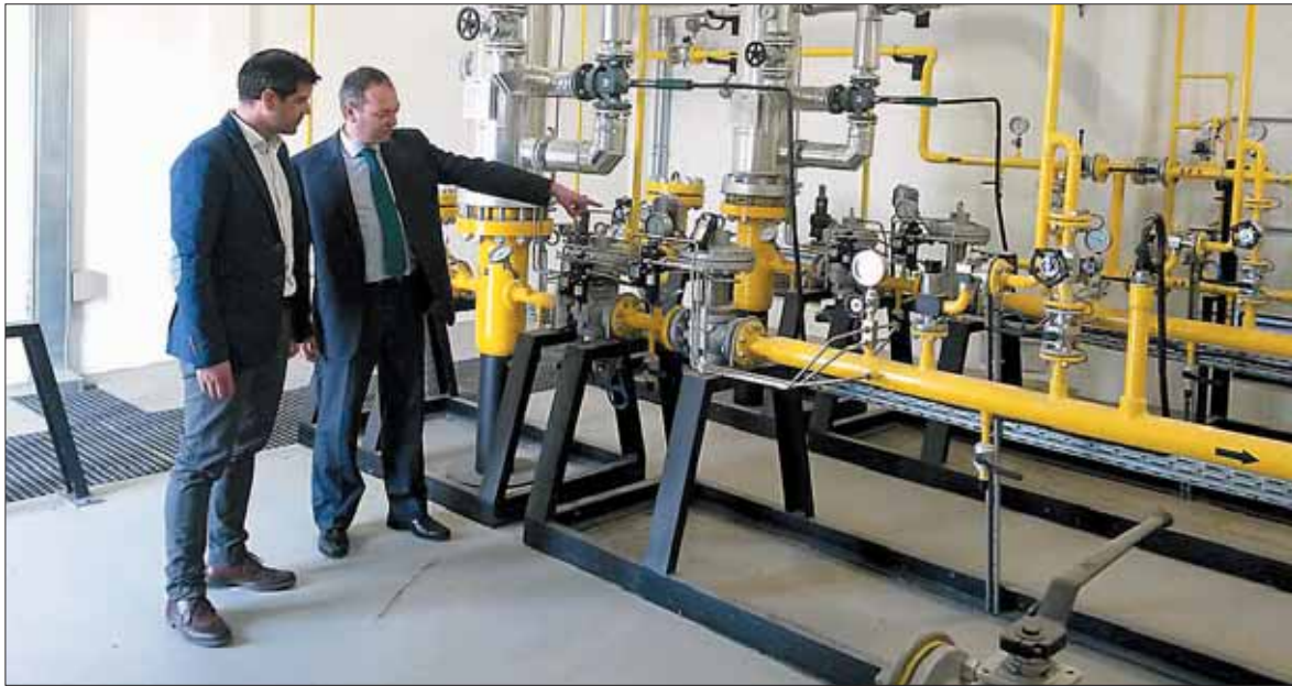
El alcalde y el responsable regional de la empresa, en la central de distribución del gas. / EL ADELANTADO
