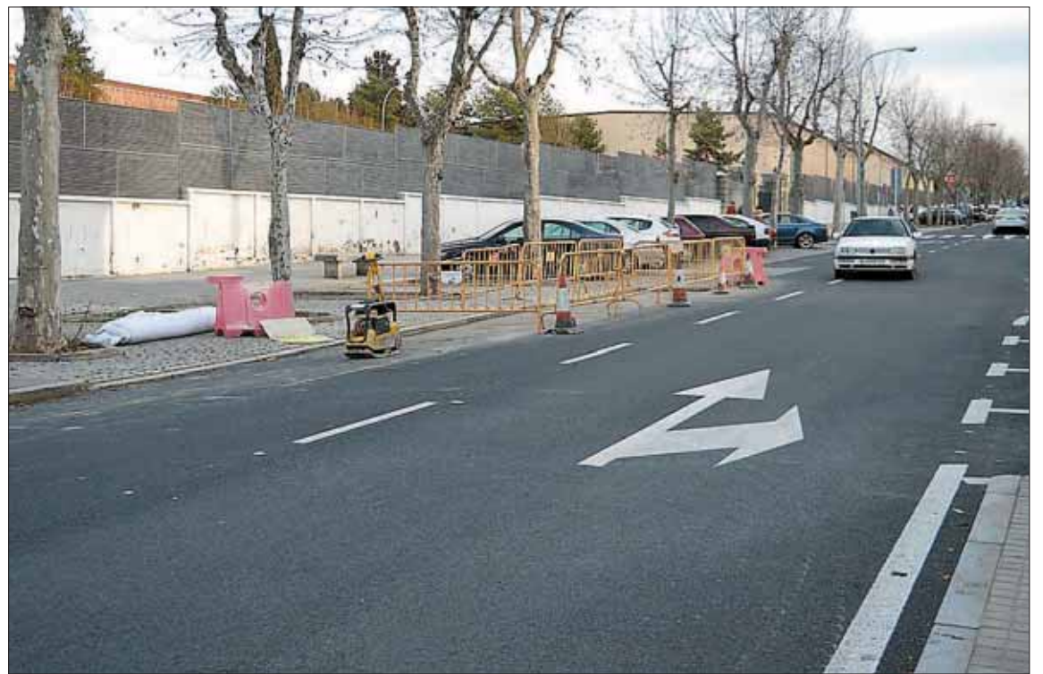
Estas obras preventivas de saneamiento de la calzada se concentran nuevamente en el margen derecho. / TAMARA DE SANTOS
