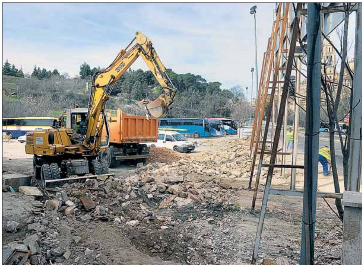
La última actuación en la zona del Velódromo fue la intervención municipal por una valla en mal estado. A la derecha de la fotografía puede apreciarse la estructura metálica del cartel donde se anunciaba la promoción inmobiliaria. / KAMARERO
