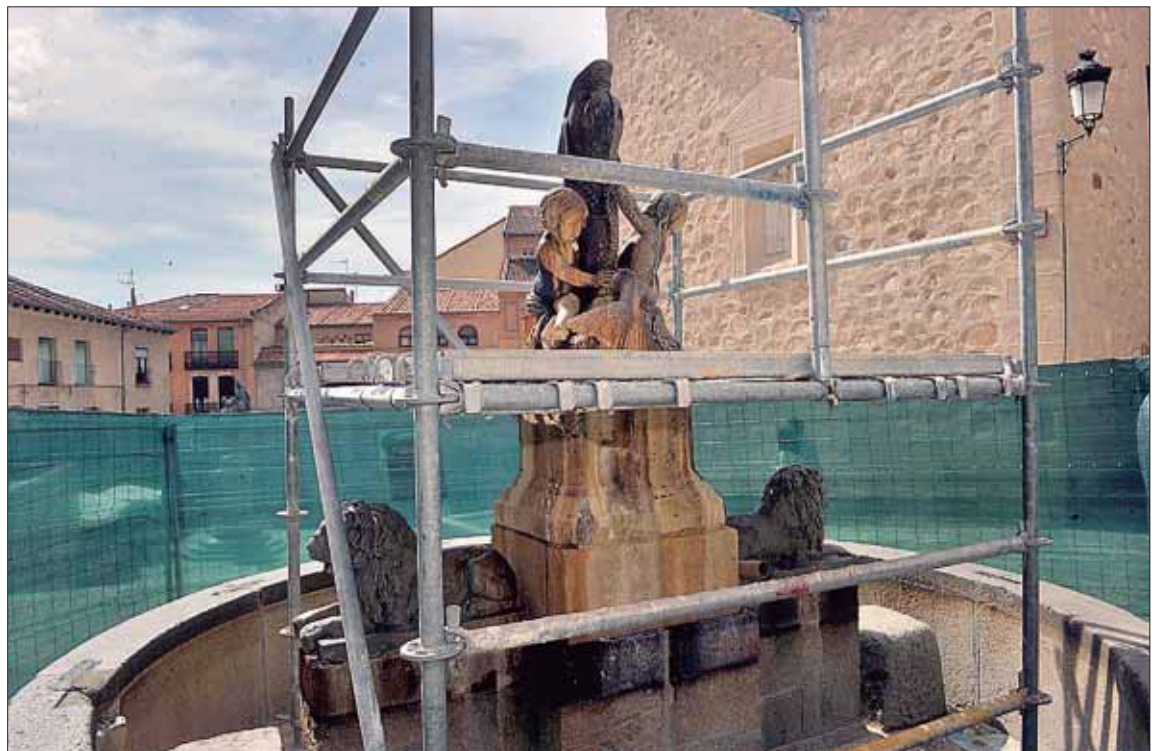
Imagen del estado de las obras de restauración de la popular fuente de Los Leones en la Plaza de San Martín. / KAMARERO
