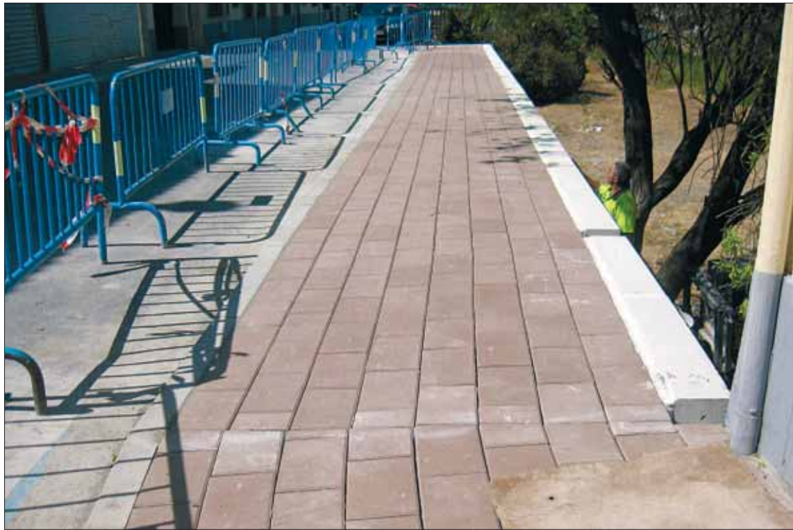
Último tramo de acera de la calle Calvario sobre el que se ha actuado./ GABRIEL GÓMEZ
