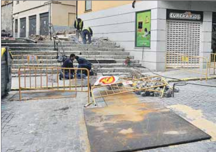
Los trabajos, ayer, de instalación de la nueva tubería en la calle Independencia. / KAMARERO
