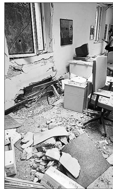
La sede de Osalan sufrió graves daños.
