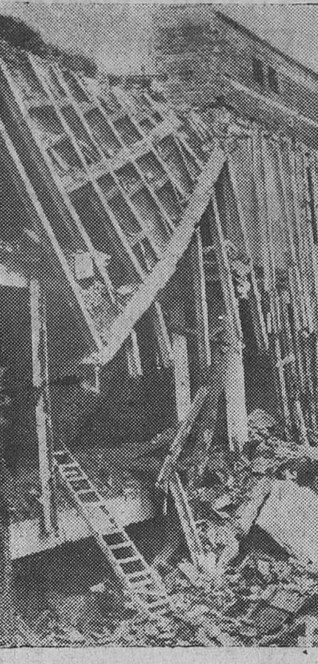
Madrid.—En este estado quedó una casa en construcción en la calle del general Lacy, que se hundió hace unos días, sin producirse víctimas, afortunadamente.
