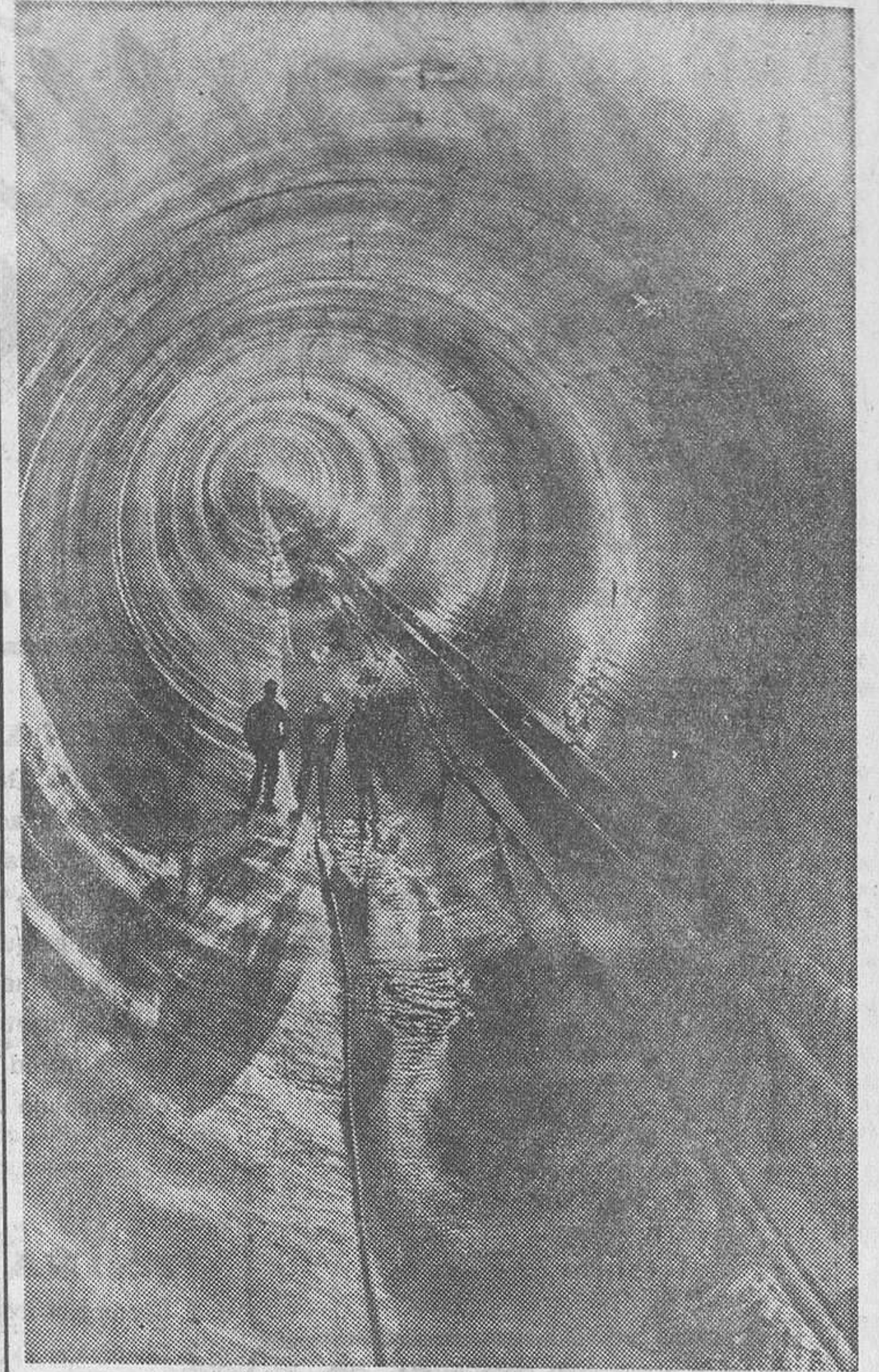
Salamanca. — He aquí un aspecto entre curioso y espectacular de la galería de conducción del nuevo salto de Villariño. La entrada oficial en servicio se anuncia para mañana, martes, en la provincia de Salamanca. La perspectiva de luces que ofrece este interior, es realmente notable. La central eléctrica se halla situada a 15 kilómetros del salto, con el que está unida a través de esta galería. Producirá un incremento de 1.560 millones de kilovatios hora. — (Foto Cifra.)
