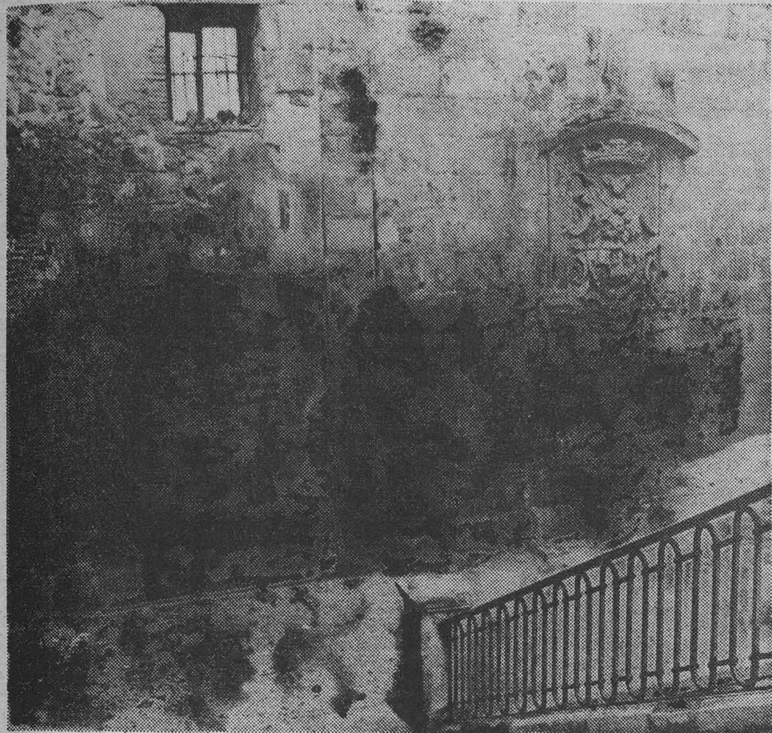
El magnífico escudo de Madrid —el más antiguo de la ciudad— está aún a salvo en la desnuda pared. Una puerta tapiada y una ventana de un piso inexistente completan la ruina. (Torremocha.)
