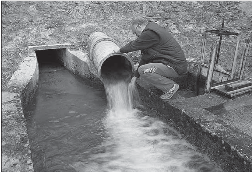
El agua procedente de los pozos subterráneos de Madrona llega a la ETAP, en la capital. / JUAN MARTÍN
