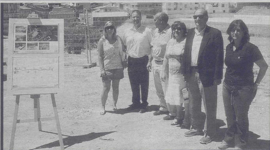
Obras en el Barranco. José Salvador Fuentes, presidente de la CHS y la alcaldesa de Elche de la Sierra, Carmen Ruiz, visitaron las obras de canalización y mejora en la zona de El Barranco de Elche de la Sierra. / CHS
