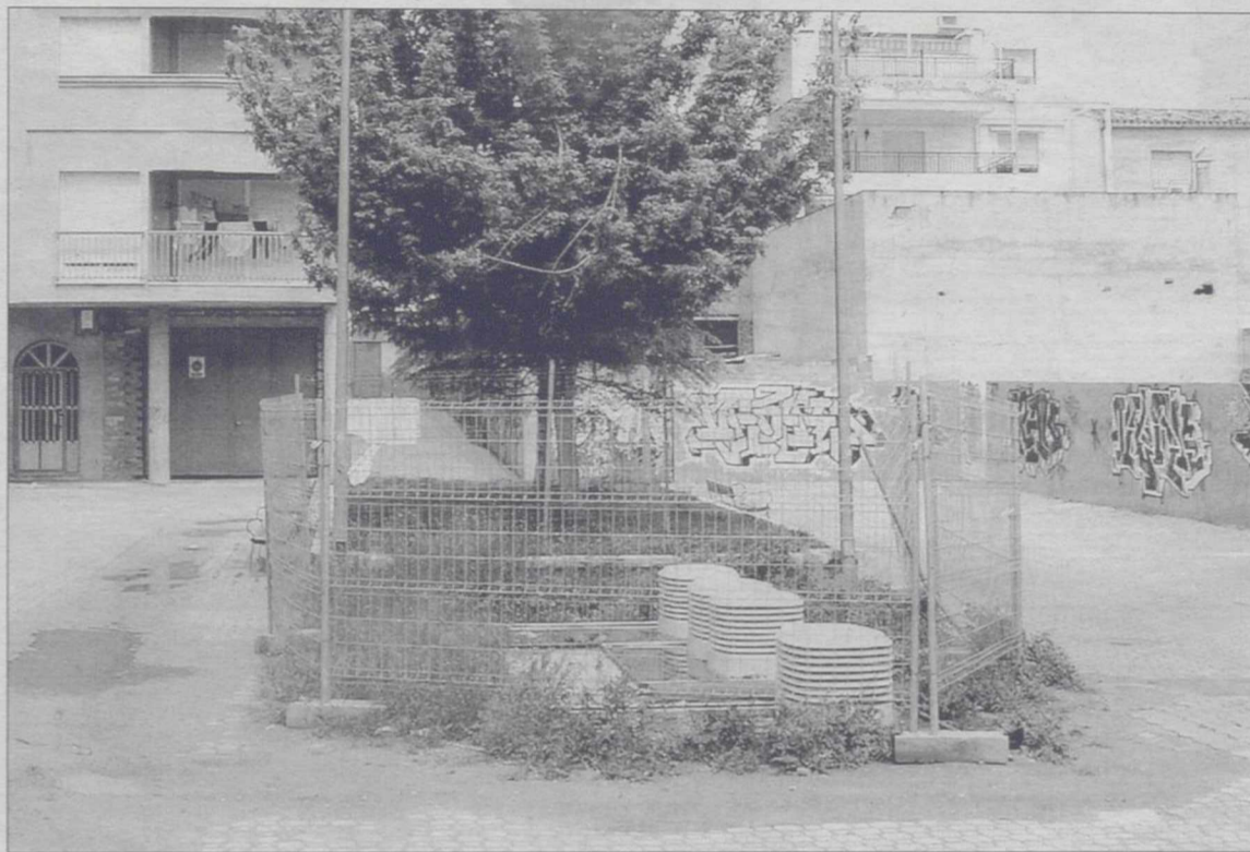
Imagen del transformador eléctrico privado en suelo público. / G. GONZÁLEZ
