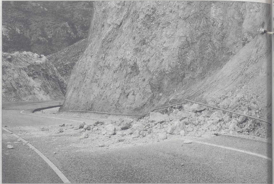
La nueva carretera que une el Collado de Hellín con Liétor, amenazada por los desprendimientos de tierra.
