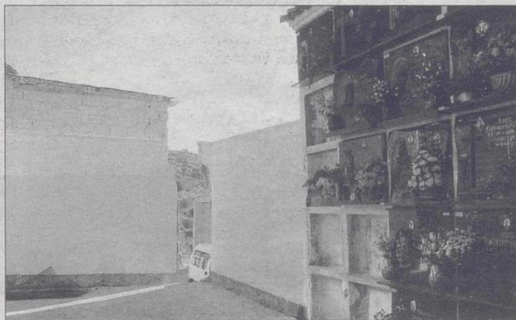
Deterioro progresivo de nichos y pabellones. / LA TRIBUNA
