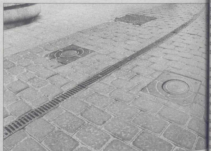
Los bolardos retráctiles están instalados, pero todavía no están activados.
