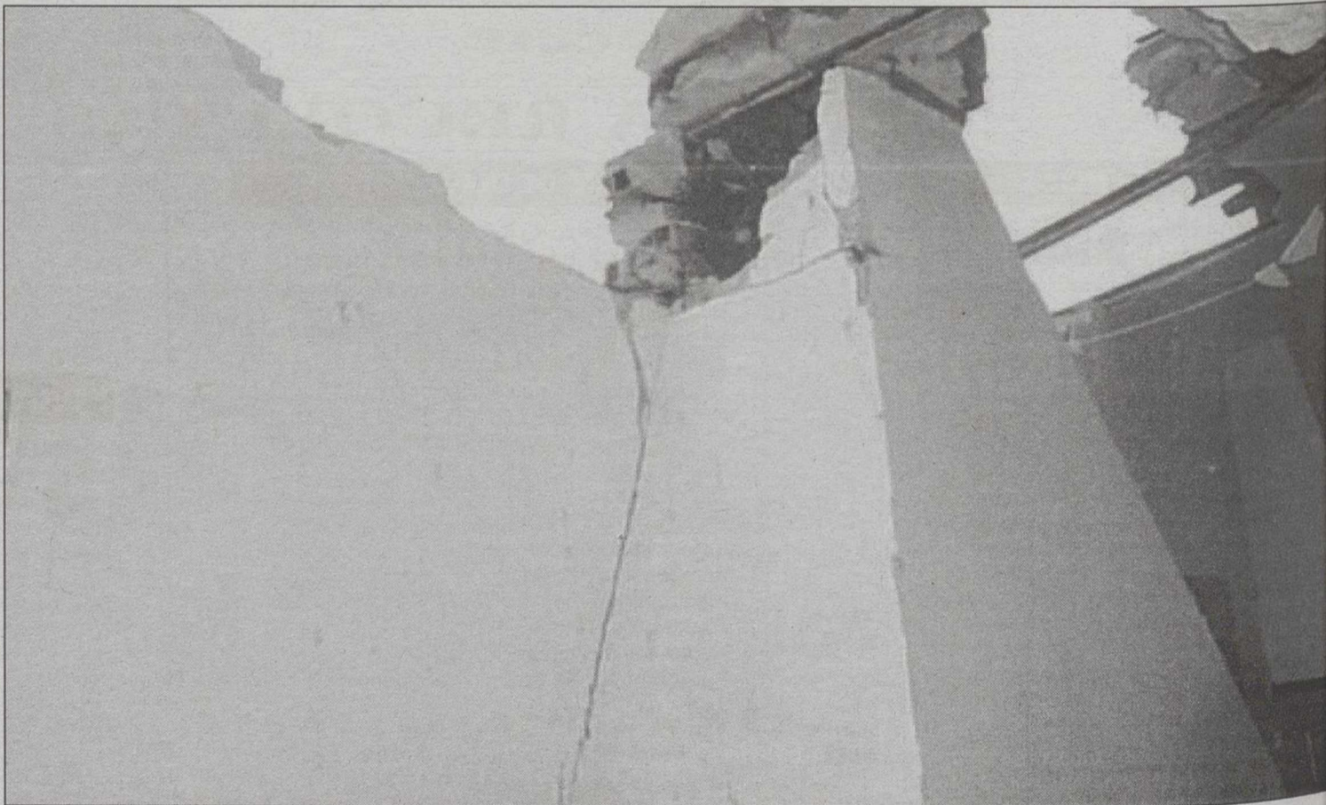
El desprendimiento de rocas produjo el hundimiento de una de las viviendas.
