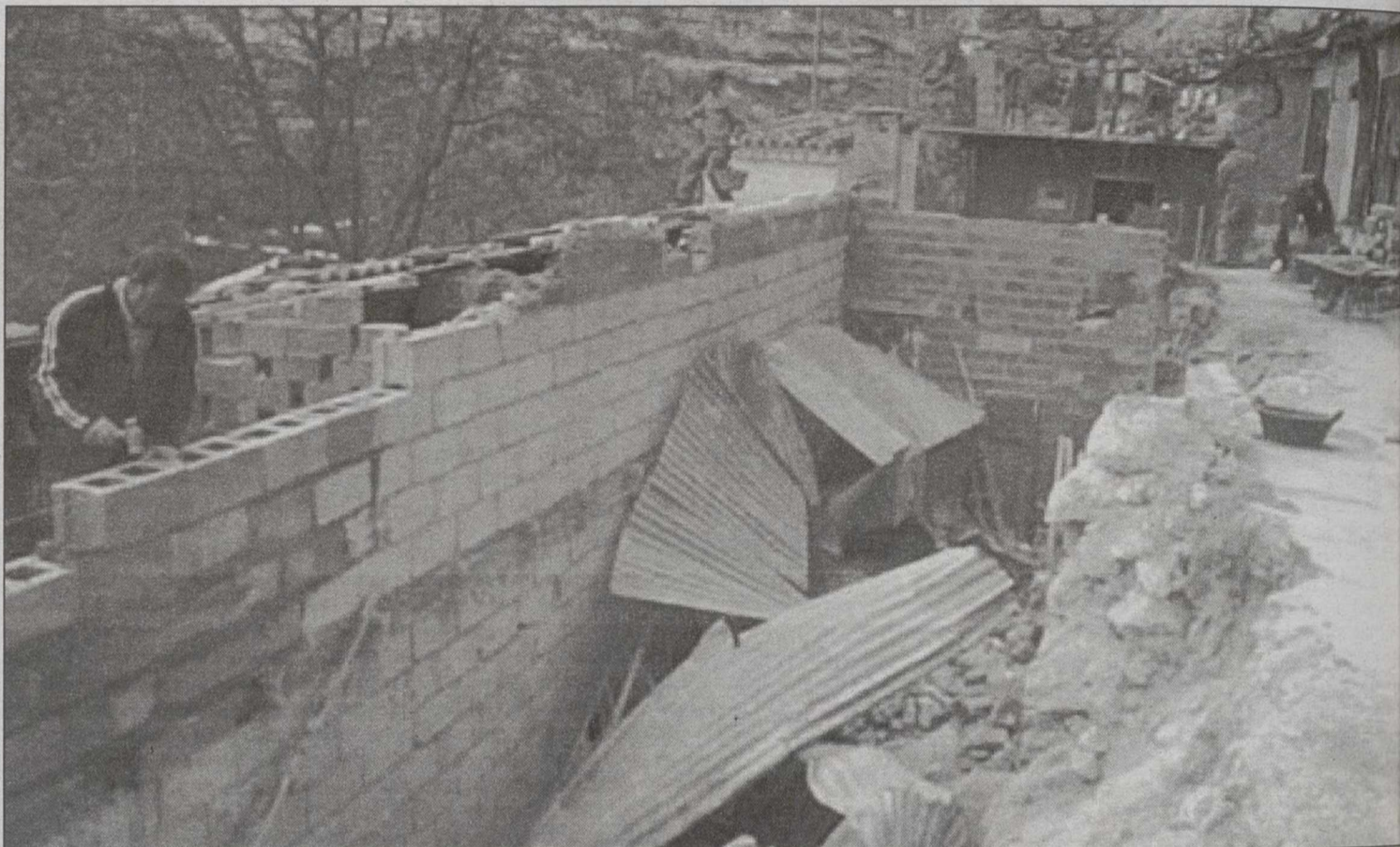
El desprendimiento ha causado importantes daños en las viviendas.
