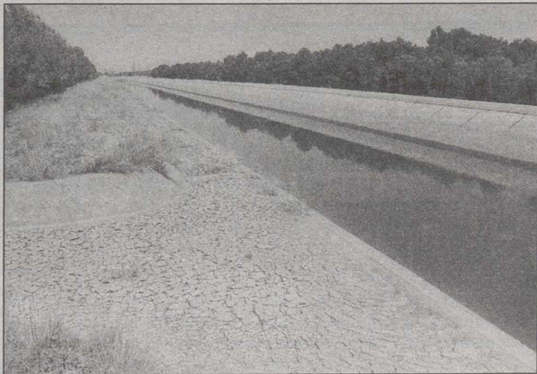
Pérdidas en las redes de distribución.
