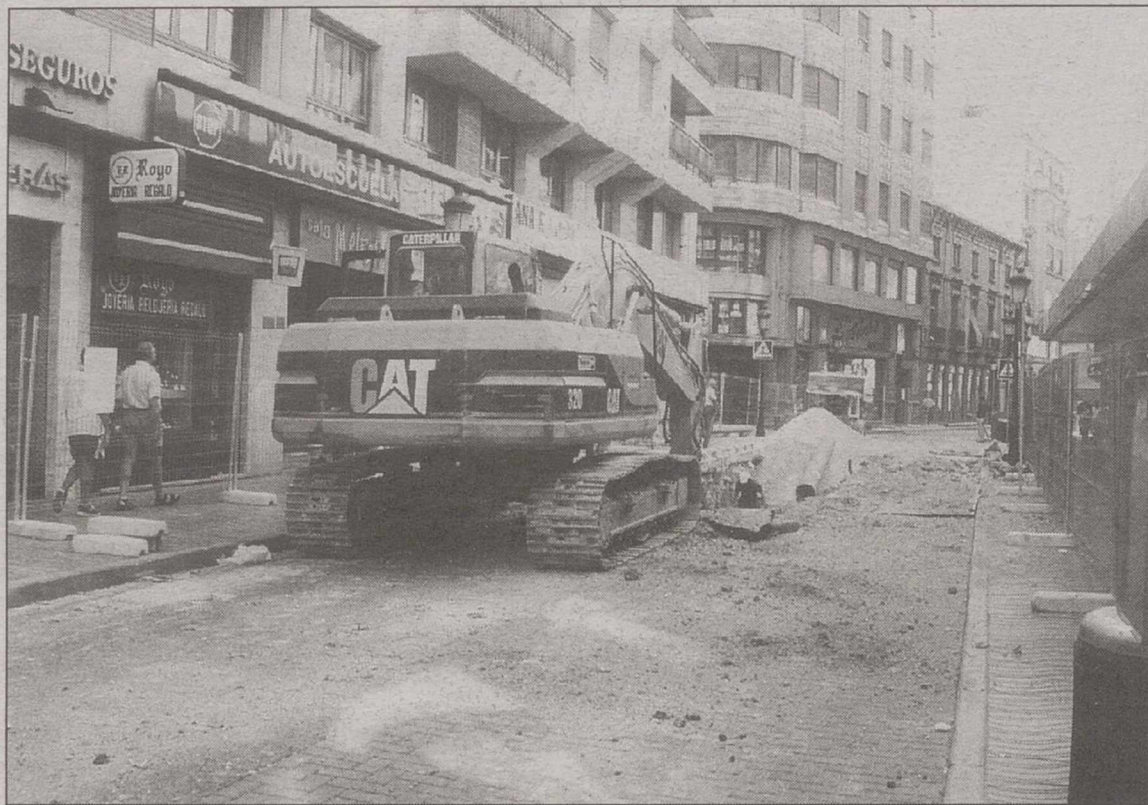
Una avería en el tendido eléctrico amenaza con volver a abrir una zanja en la Calle Ancha.
