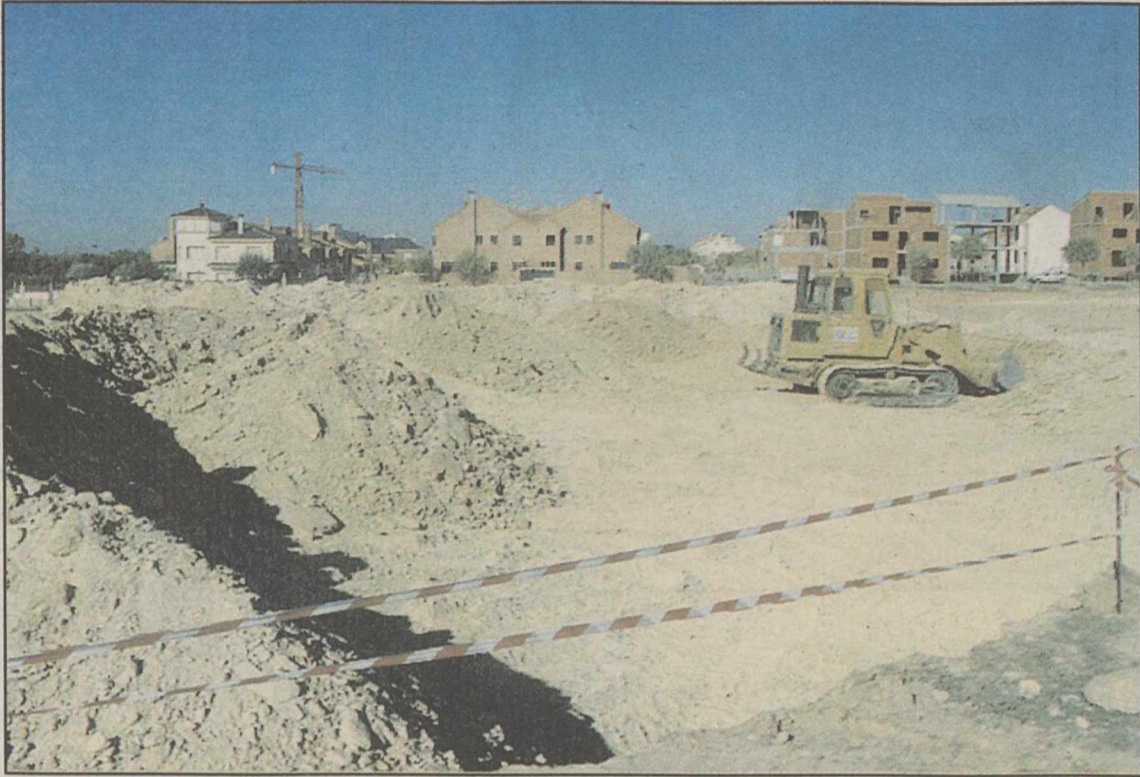
En estos momentos se está nivelando el terreno donde estarán ubicadas las nuevas pistas de atletismo. JOSEMA MORENO
