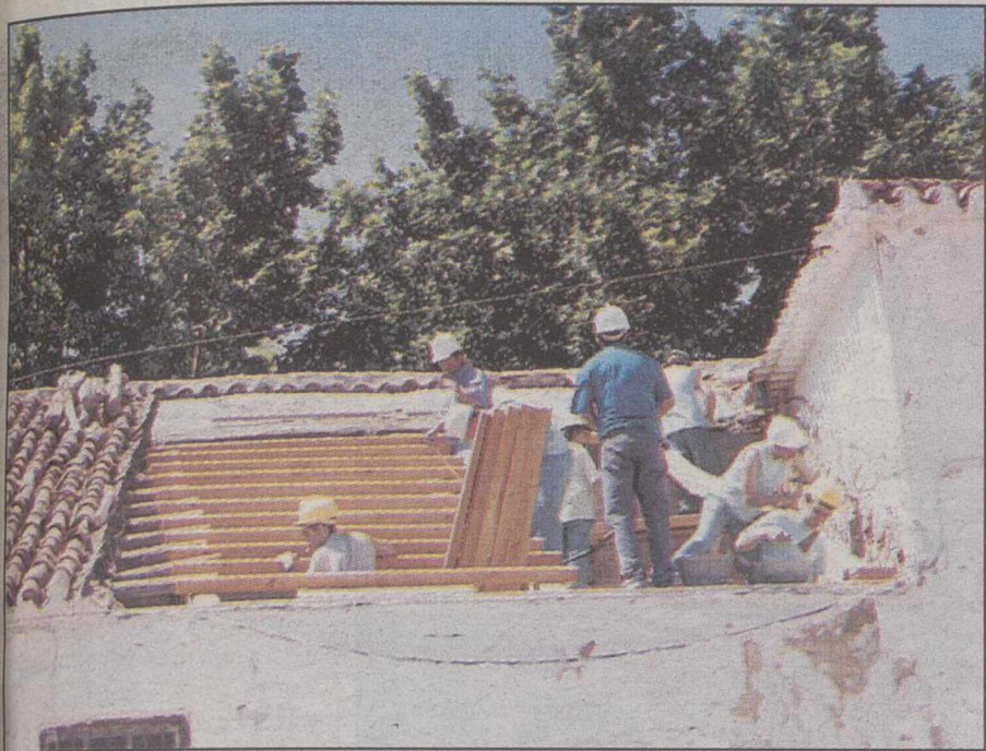
La reconstrucción de la cubierta en el Recinto Ferial es una de las actuaciones llevadas a cabo.
