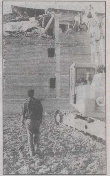
Precintos en construcciones.
