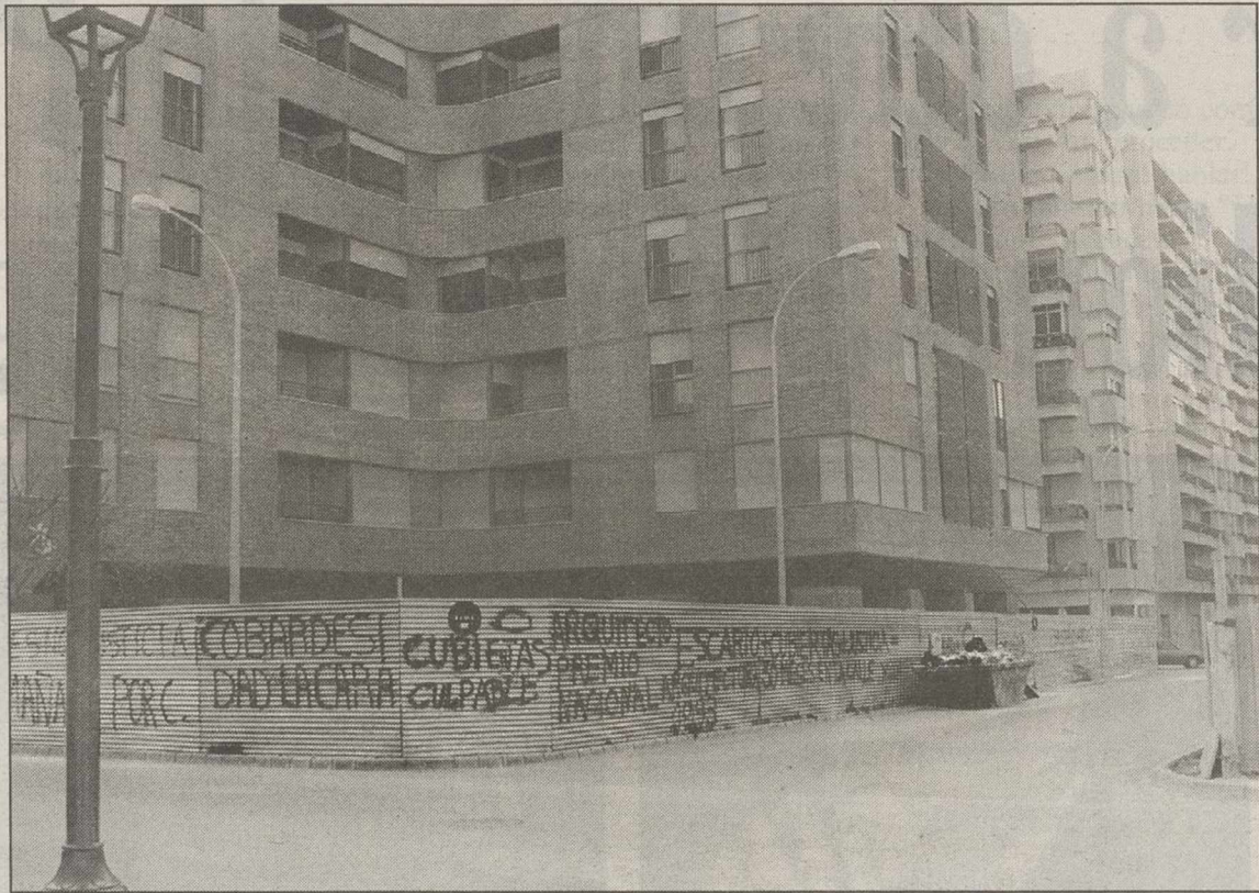
Las obras de reparación de las deficiencias del "edificio Chinchilla" están en su fase de acabado.
