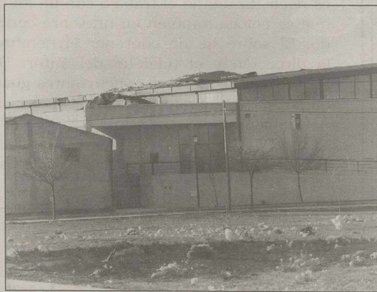
Estado en que quedó la cubierta del Polideportivo.
