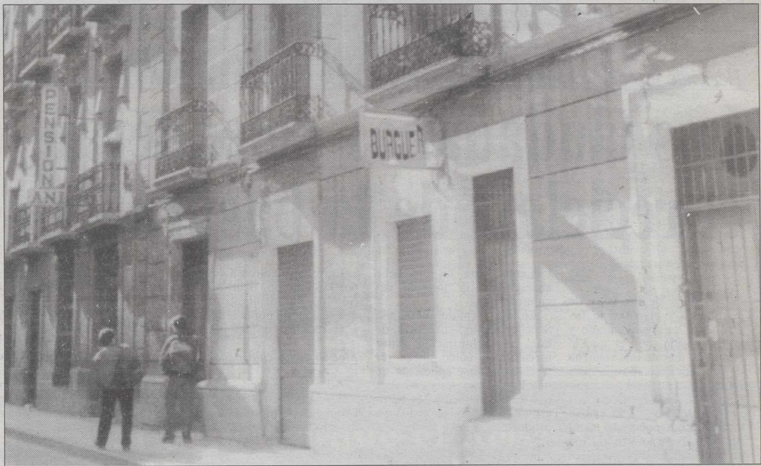
Los propietarios de inmuebles en mal estado de conservación son responsables de mantenerlos en debidas condiciones.
